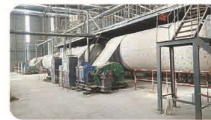
JD-TECH球磨机生产车间应用 JD-TECH Ball mill running factory
